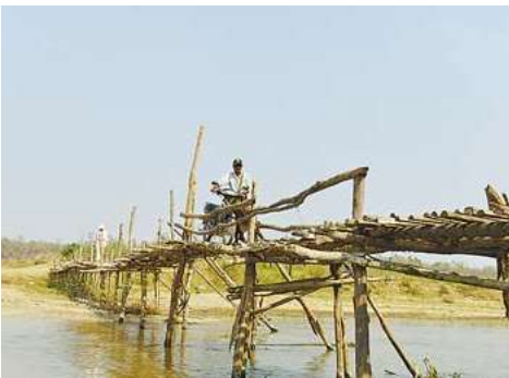
洪水のたびに流された木製の橋
