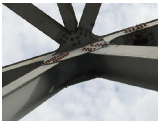
写真-4.56 トラス主構の錆
