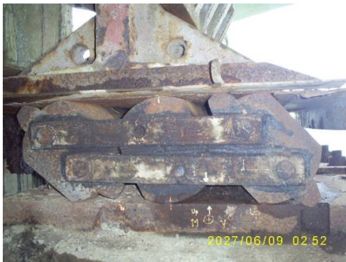
写真-3.5 Maubin 橋の沓の変状 (1)
