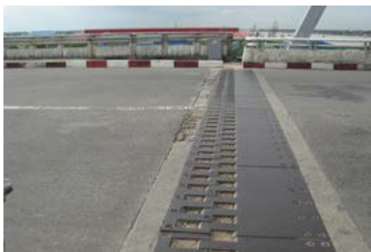
写真-4.57 痛んだ伸縮装置
