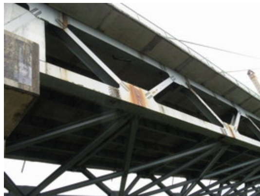
写真－4.42 路面排水による錆
