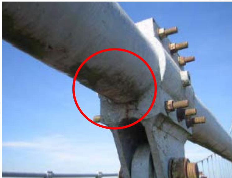
写真－4.73 主ケーブルラッピングに見られるみずみち
