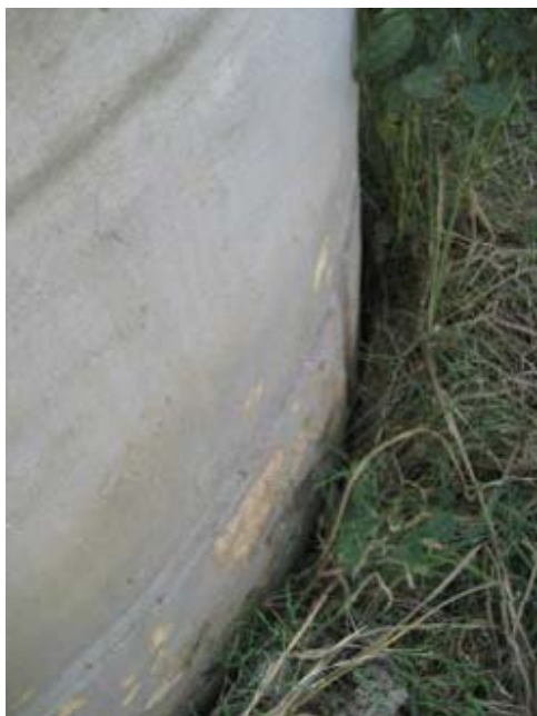
写真-4.79 主塔と背面地盤の隙間
