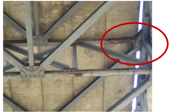
写真-4.83 上弦材の腐食
