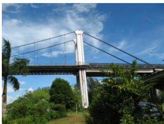
写真-4.19 傾いた塔
