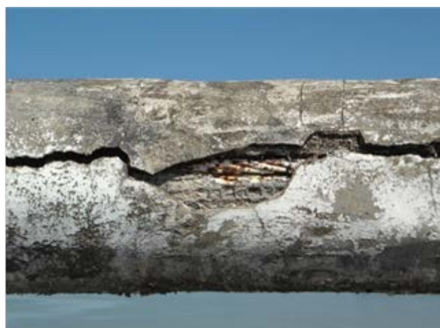
写真-4.39 主ケーブルの被覆の割れと腐食
