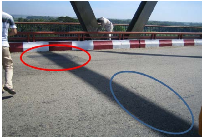
写真-4.34 アスファルト舗装の損傷
