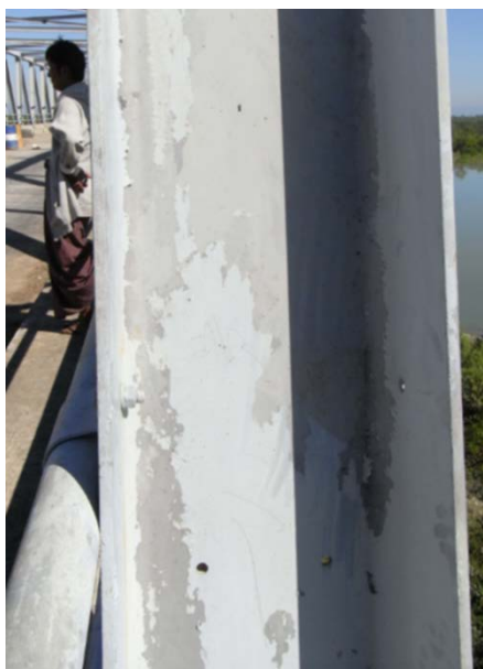
写真-4.69 トラス構造物部材の塗装はがれ
