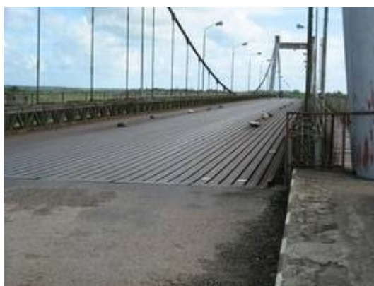
写真-4.20 路面の石は通行規制？
