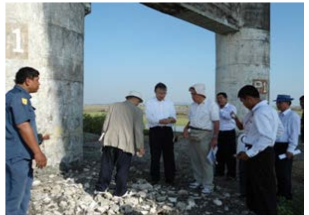
写真—4.61 橋脚の周りに散乱している剥がれたコンクリート片
