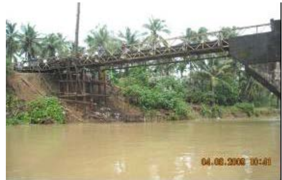
写真-3.4 その後の出水で仮設橋の橋脚 が流され通行止めとなっている
