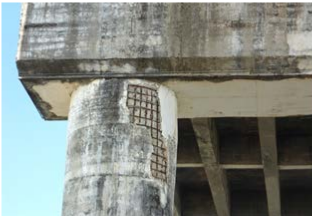
写真—4.60 大きくコンクリートが剥がれ落ちた橋脚
