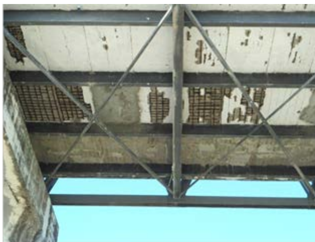
写真-4.76 プレキャストコンクリート版の損傷
