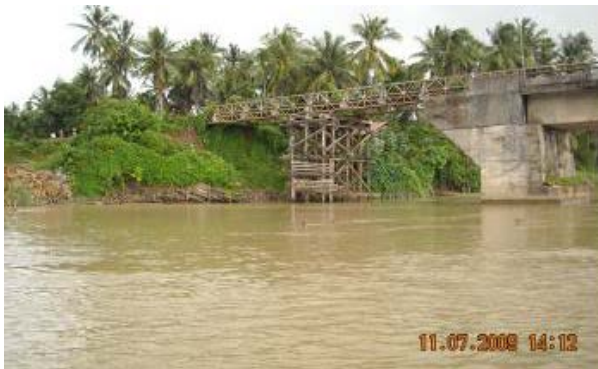
写真-3.3 出水により橋台背面が洗掘され 仮設橋により交通が確保されている
