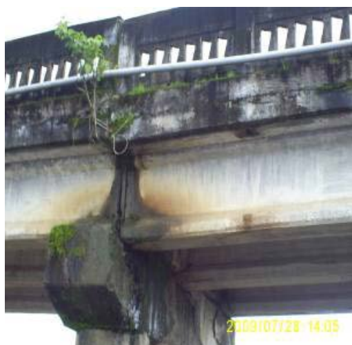
写真－4.4 下部工から落ちそうな コンクリート桁
