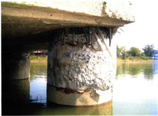
写真-3.11 杭頭部の施工不良箇所
