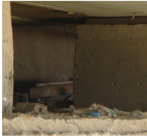
写真-4.49 橋梁天端に落下していたビーム
