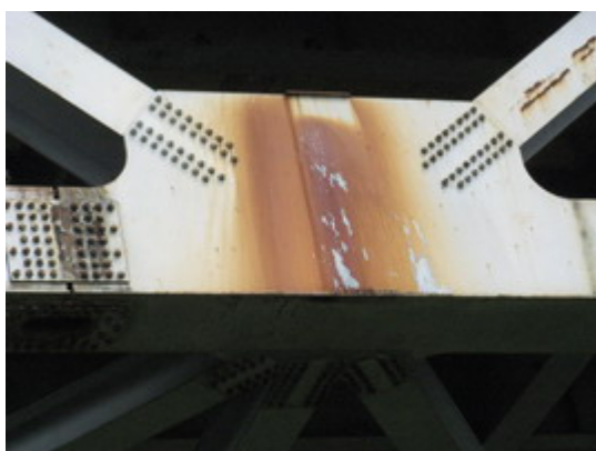
写真－4.43 路面排水による錆
