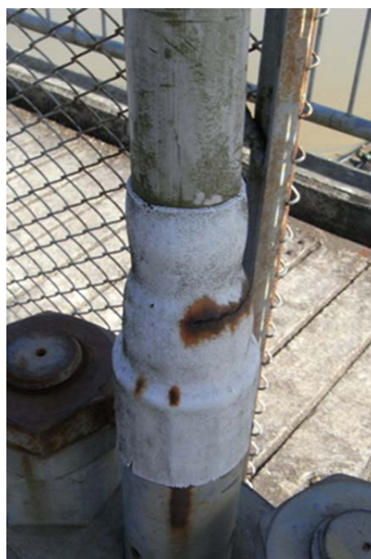
写真－4.74 ハンガーの FRP 被覆の割れと剥がれ
