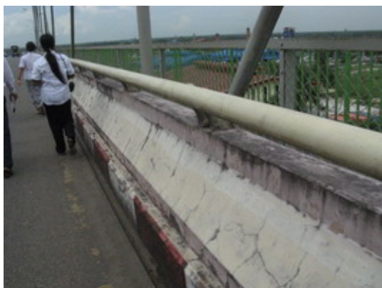
写真-4.45 コンクリート高欄のひびわれ
