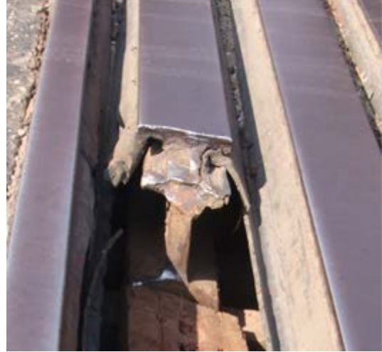
写真-4.48 破断したビーム
