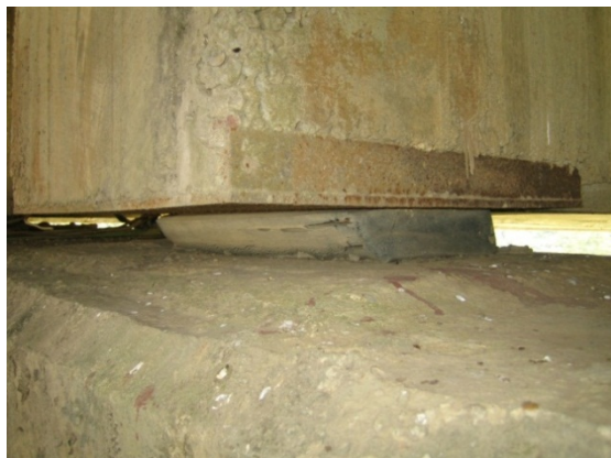
写真-4.25 大きくせん断変形したゴム沓
