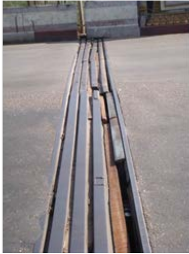
写真-4.47 伸縮装置の損傷状況
