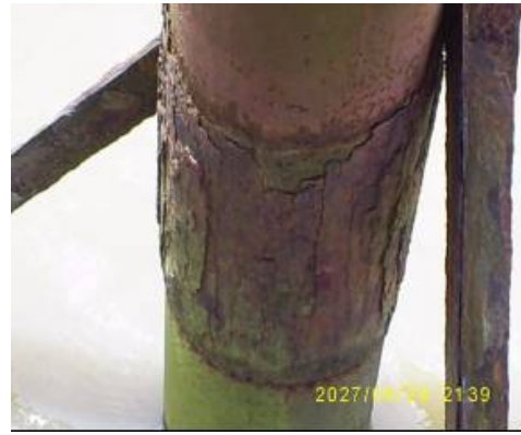
写真-3.10 パイプの劣化状況
