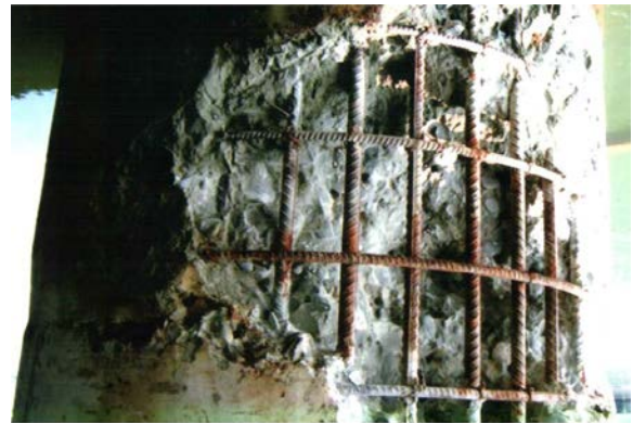
写真-3.12 杭頭部の施工不良箇所
