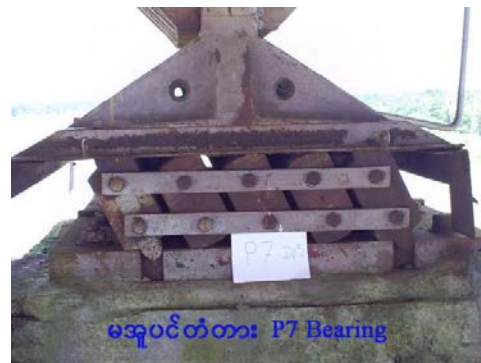
写真-3.6 Maubin 橋の沓の変状 (2)
