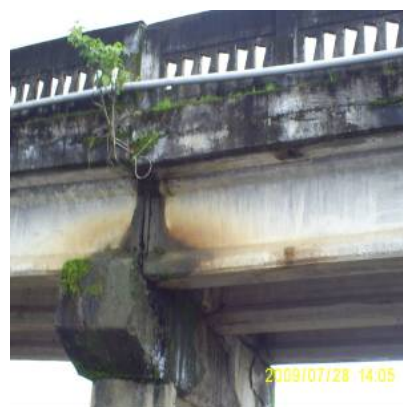
写真-3.2 下部工から落ちそ うなコンクリート桁
