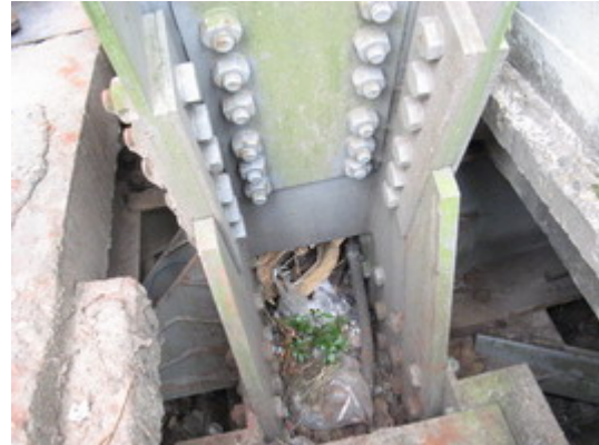
写真-4.16 トラスの格点部のごみ
