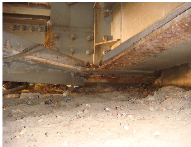
写真-4.9 可動沓（ヤンゴン側）
