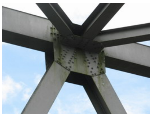
写真－4.33 トラス格点部の錆
