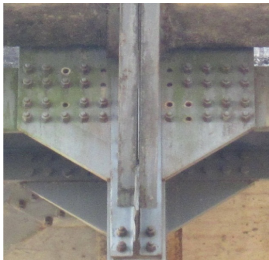
写真-4.72 トラス添接版のボルトの欠
