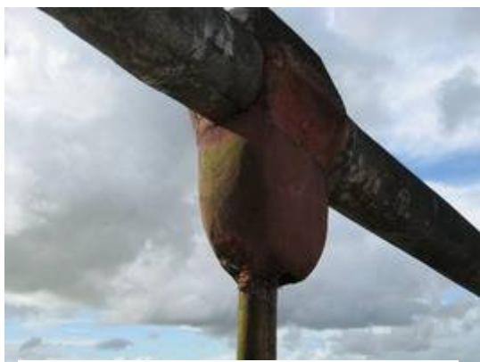
写真-4.21 セメントモルタルによる防食？
