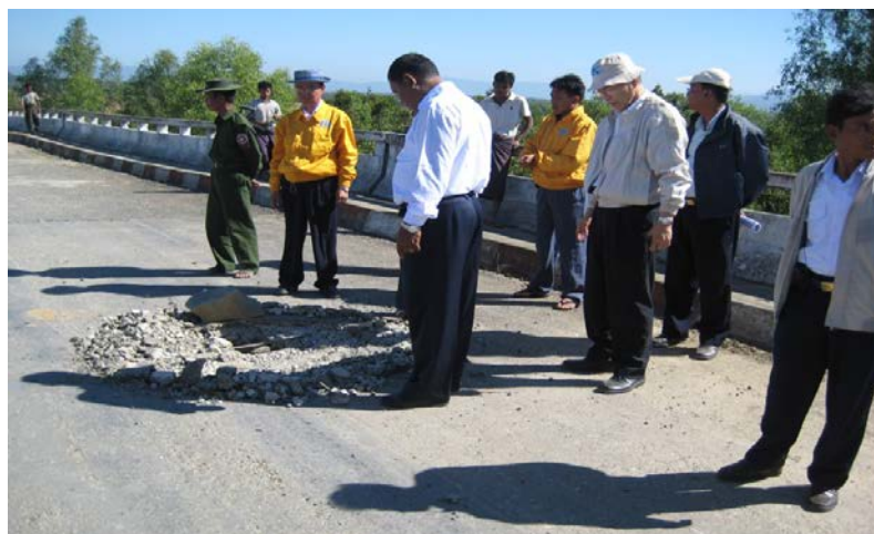
写真-4.68 床板の損傷に伴う路面の陥没
