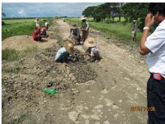
写真-22 一応路面の補修は行われている。PW の Road Construction Special Unit (RCSU)が直営で実施している。大型機械が入らないところは人力で補修しているが、補修のやり方に問題がある。
