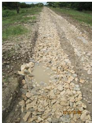
写真-24 人力による補修方法に問題があるので、路面はまたすぐに壊れてしまう。
