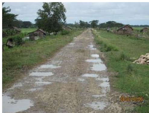
写真-21 大型車両に対応した路面処置になってないので、短期間のうちに路面が壊れてしまい、道路としての十分な機能を発揮していない。
