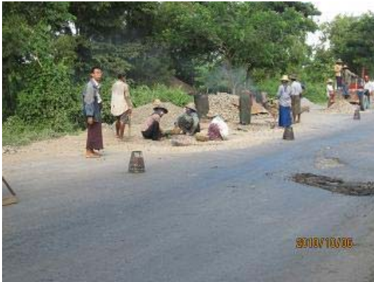
写真-11 舗装は日本でいえば簡易舗装であるが、幹線国道であるため大型車の交通量が多く、あちこちで舗装が痛んでいる。しかし、維持補修はこまめに実施されていた
