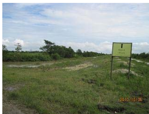
写真-28 Bogale 付近で No.1 Road から分岐する No.5 Road. 盛土は完成しているが路面処理が出来ていないので、車両はまだ通行できない。
