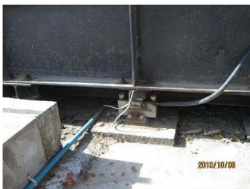
写真—9 桁の下にロードセルがあり、料金所の中にあるコンピューターに繋がっている。
