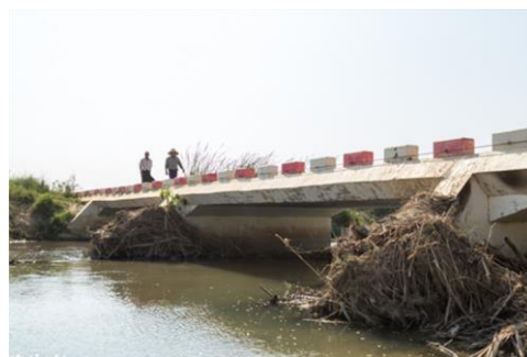
橋桁に残ったままの流木
