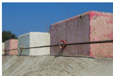
地覆の外側に設置されたロープ
