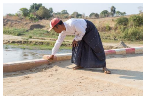
橋と取付け道路にできた約 6 センチの差
