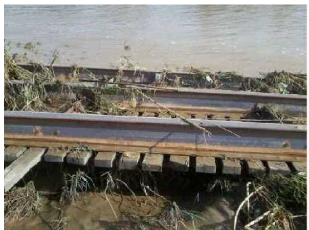
写真 3.9 流失した橋梁上部工(2)
