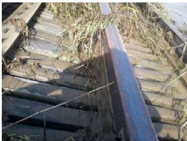
写真 3.8 流失した橋梁上部工(1)
