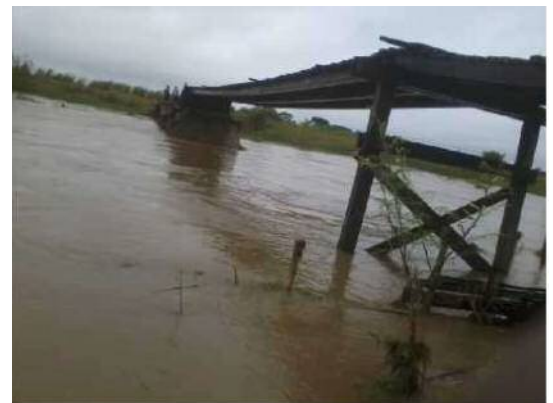
写真 3.3 流失前の状況
